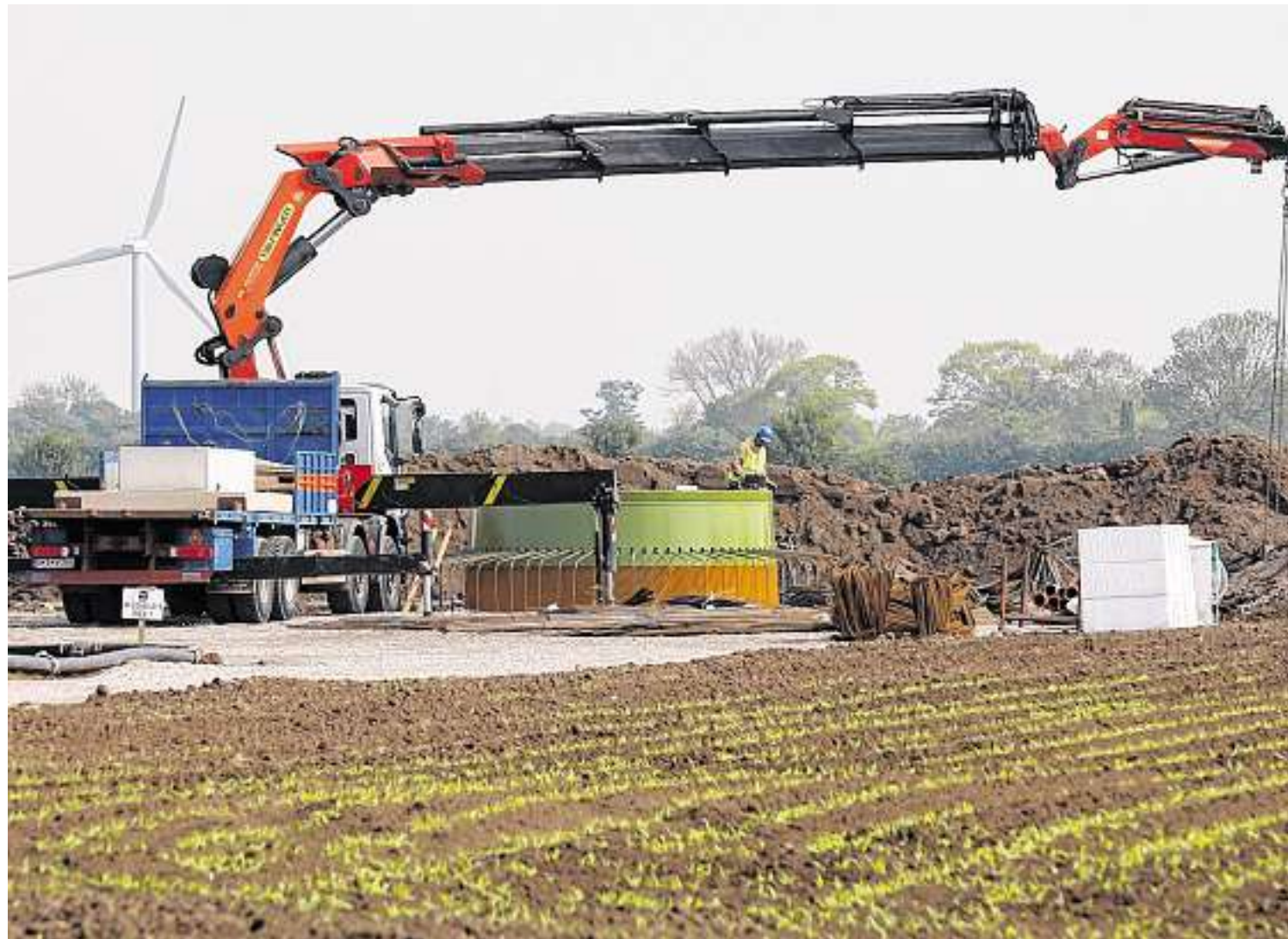
Baustelle im Beppener Bruch in Thedinghausen: Die vorbereitenden Tiefbauarbeiten fanden bereits im April statt, seit heute wird das Fundament betoniert. Montage und Inbetriebnahme beginnen Ende Juli und dauern voraussichtlich bis Ende August. FOTO: STRANGMANN
