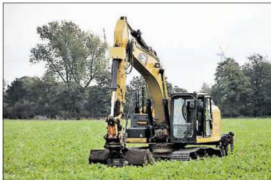
Ein Baggerfahrer bereitet auf einem Rübenfeld den Bodenaushub für eine Baustraße vor.
