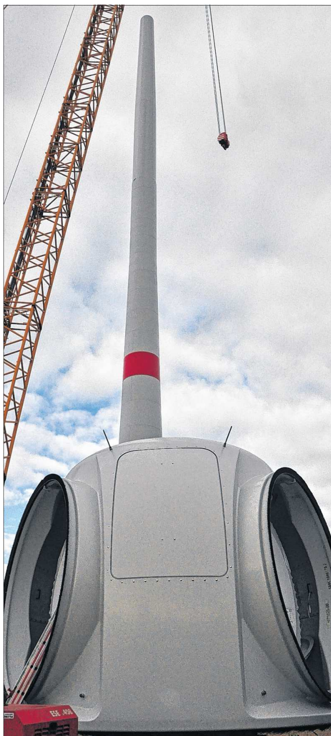
Diese Nabe, an der die Flügel einer Windkraftanlage befestigt werden, wartet im Windpark Lüge/Thüritz darauf, in eine Höhe von 141 Metern gehievt zu werden.
