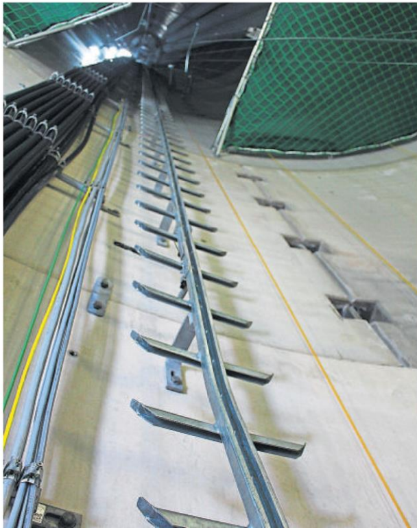
Die Wartungstreppe führt bis unter die 135 Meter hohe Nabe, muss aber nur im Notfall benutzt werden; es gibt auch einen Fahrstuhl.
