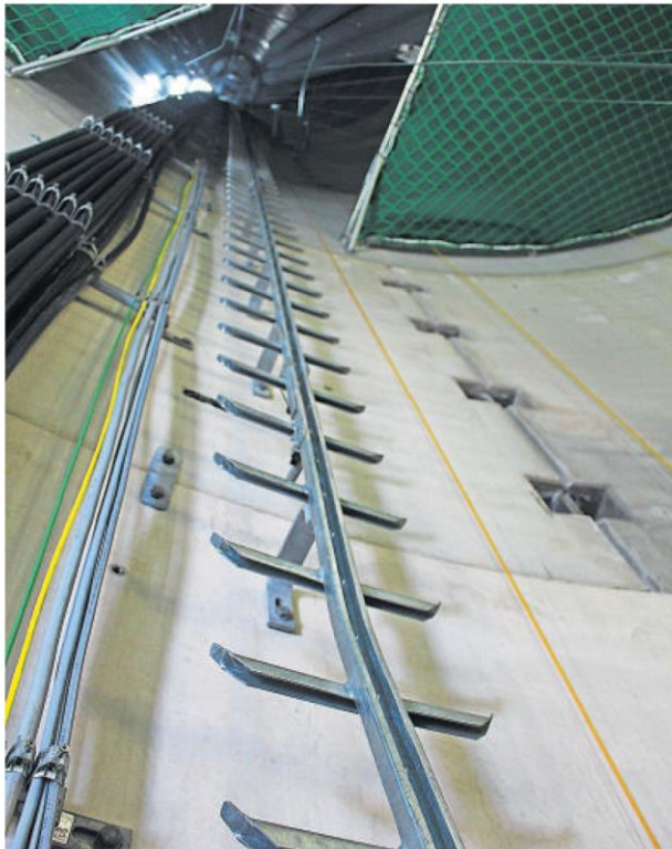
Die Wartungstreppe führt bis unter die 135 Meter hohe Nabe, muss aber nur im Notfall benutzt werden; es gibt auch einen Fahrstuhl.
